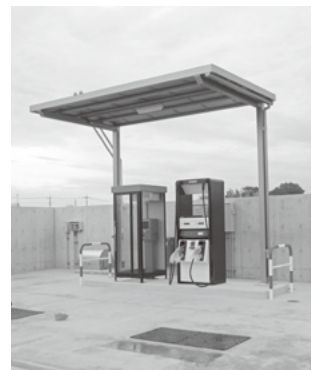
自家用給油設備
