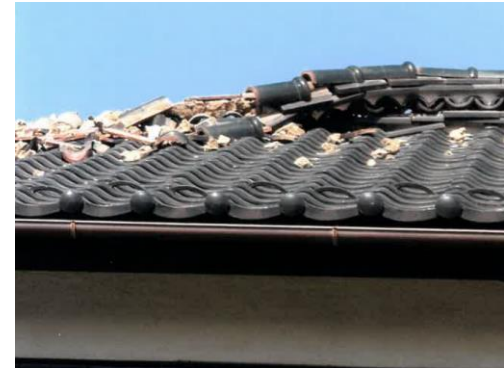
鶴ヶ島市内住宅：屋根瓦破損の様子
