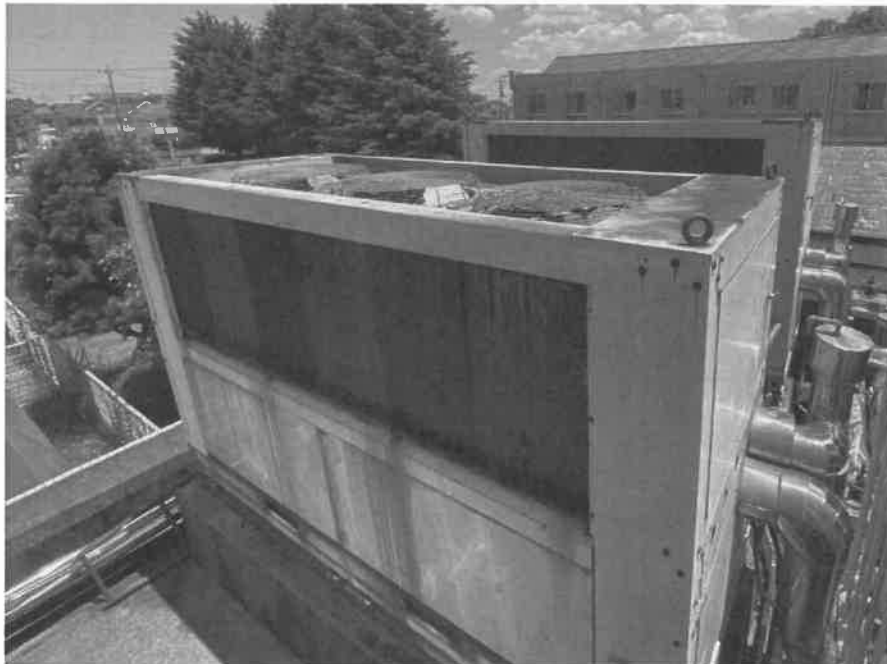
女性センター空調機屋外機器の外観
