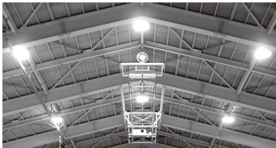
【LED照明導入前】
