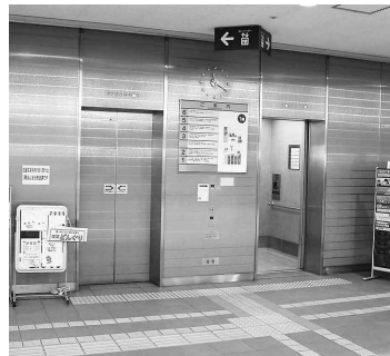
庁舎内のエレベーター
