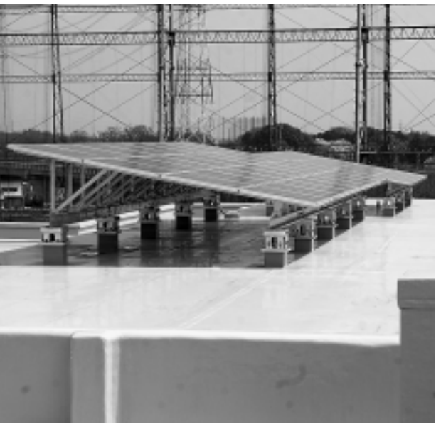
屋上太陽光パネル
