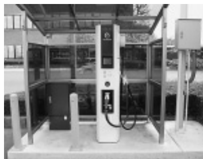
市役所に設置の電気自動車用急速充電器
